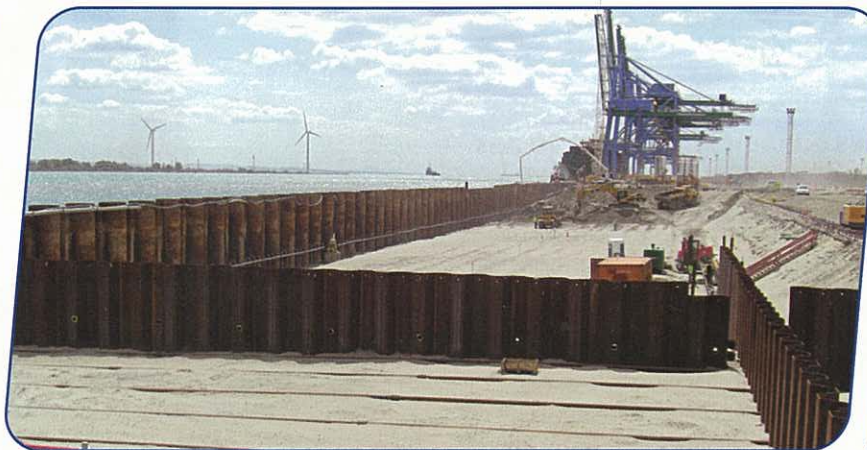
Dans la construction d'un quai, les tirants « ancrent » le mur du palplanches.
